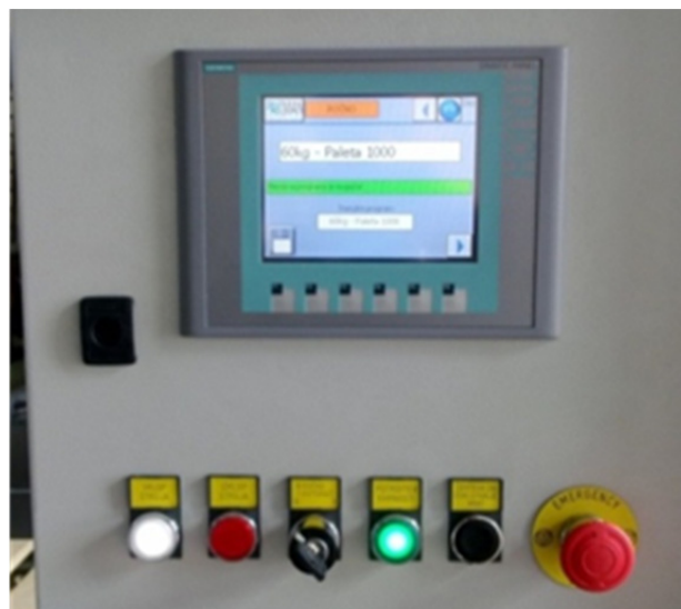
Slika 5: Krmilna omarica z (OP) operatorskim panelom.
