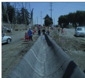
Slika 6: Sesedanje cevi zaradi vakuuma.
